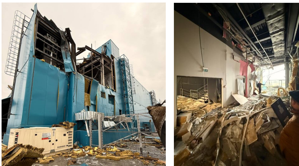
Рис. 3. Пошкодження будівлі внаслідок аварійного впливу
