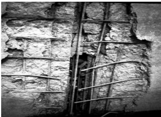
Рис. 1. Ушкодження стиків з'єднань залізобетонних плит морського причалу
