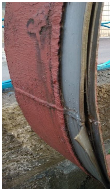
Рис. 7. Фрагменти багатошарової котушки, яка служила в якості пастки для зупинки тріщин в газопроводі
