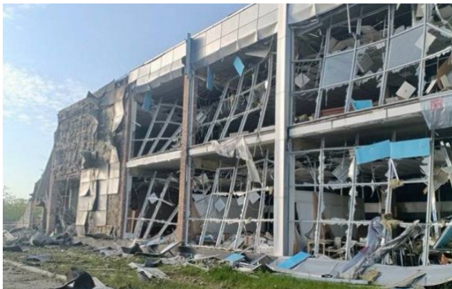
Рис. 3. Руйнування вітражів каркасної будівлі торговельного центру в результаті російських ракетних обстрілів, м. Миколаїв, 16 травня 2023 р.
