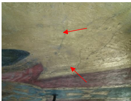
Рис. 5. Тріщини в тинькуванні в осях В-Г×5-6
